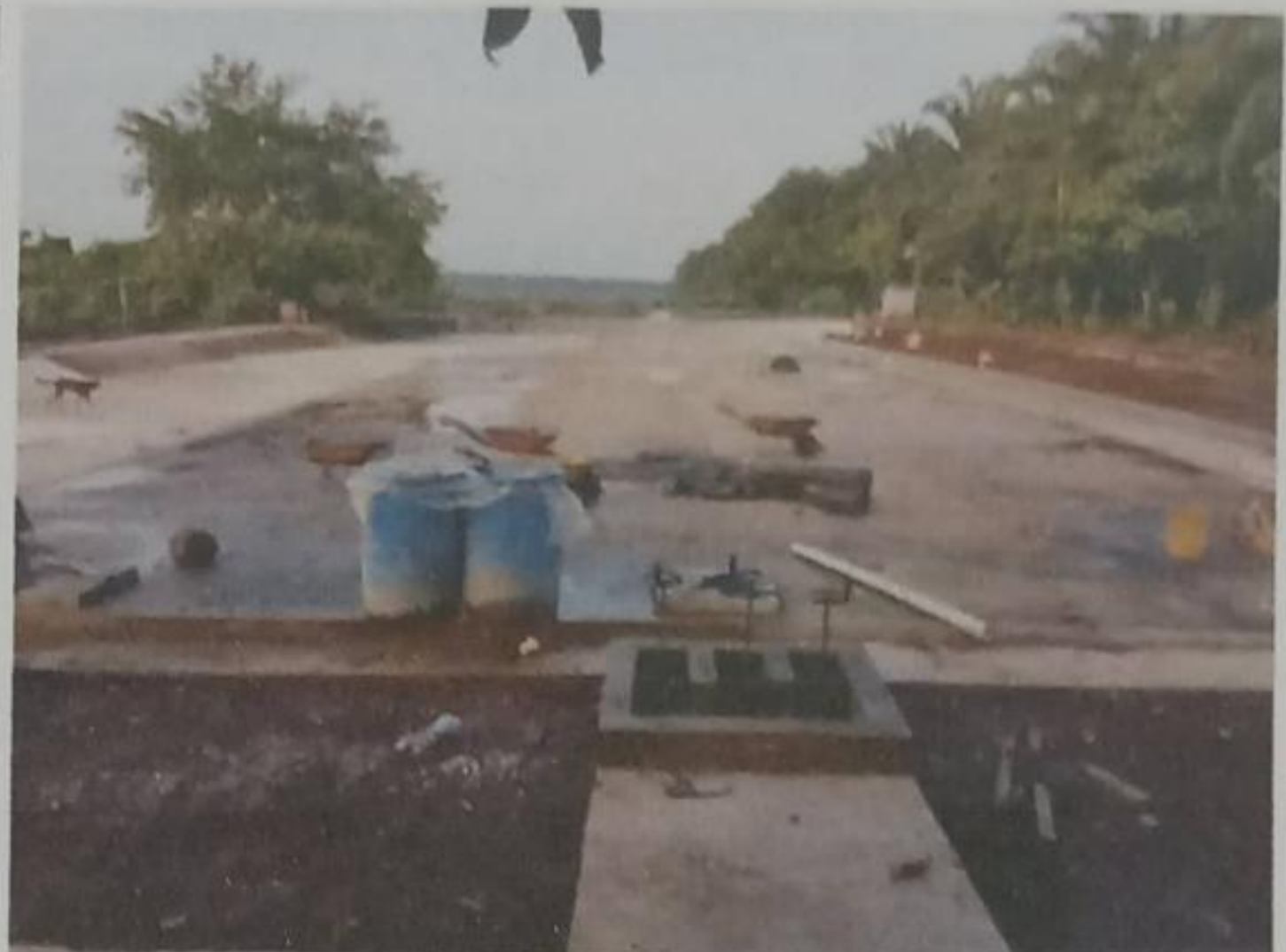
Vista de caja distribuidora de caudales y Sedimentadores primarios
