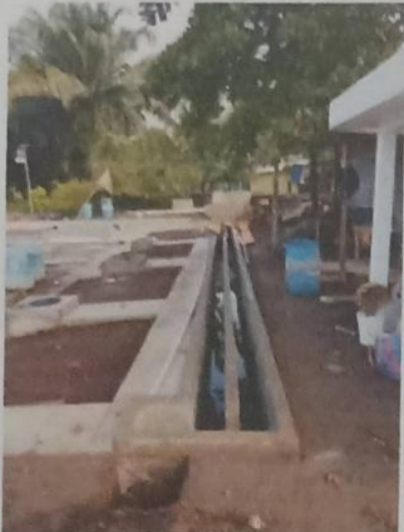
Vista de canal de rejillas y Desarenador
