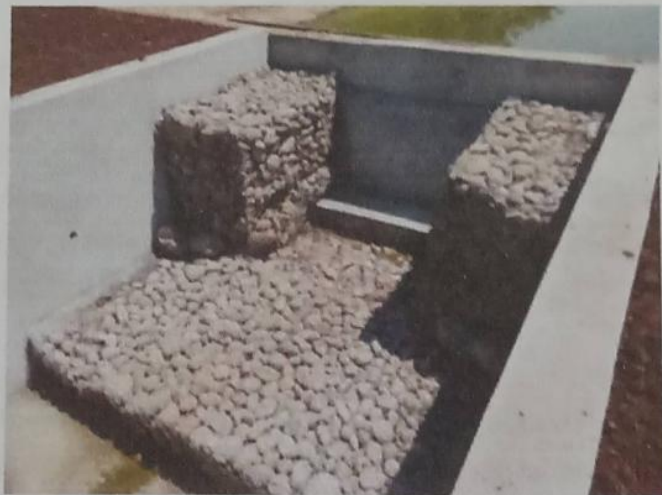
Vista de Filtros percoladores en descarga y humedal
