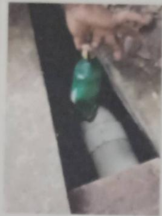
Caja de cloración
