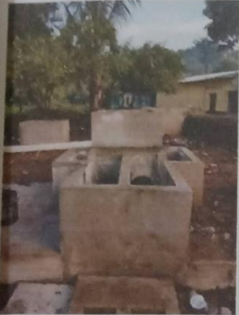
Vista de caja de demasías y Distribuidora de
