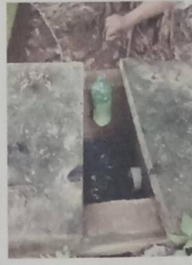
CAJA DE CLORACION
